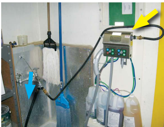
Figure 68 - Vue d'ensemble de la cuve de concierge Source : CMMTQ.
