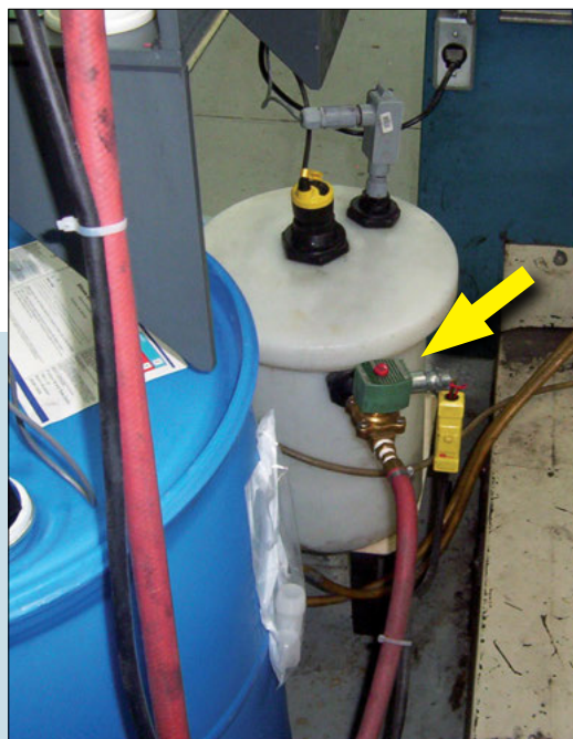
Figure 98 - Vanne électromagnétique bloquée Source : CMMTQ.
