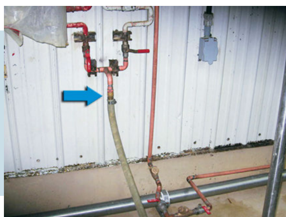
Figure 92 - Robinet de lavage non isolé Source : CMMTQ.
